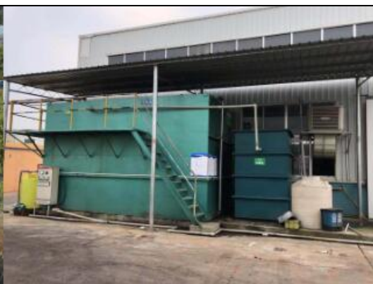
自建污水处理站
