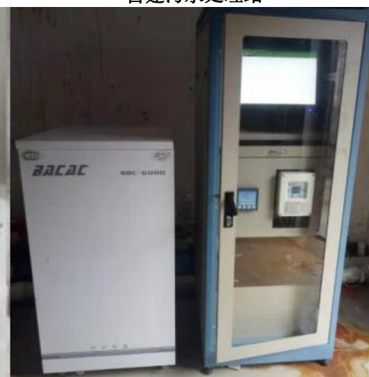
废水在线监测设施
