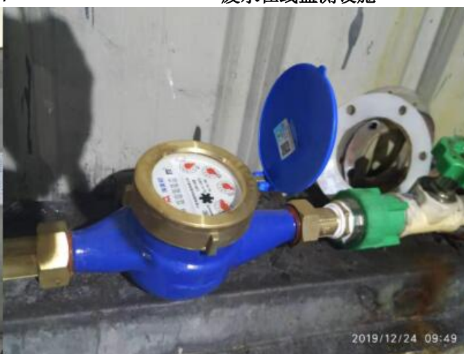
磷化皂化生产线独立水表
