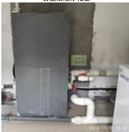
生产废水处理设施标排口
