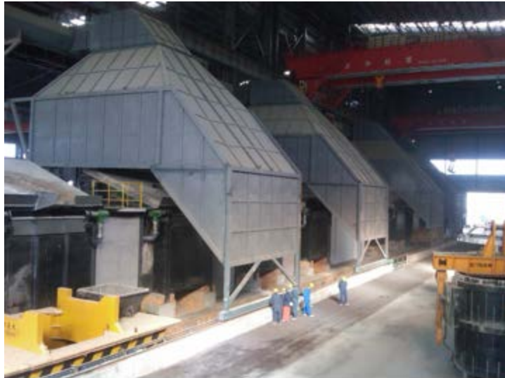
图 7-3 项目拟设中频炉废气集气装置实例图
