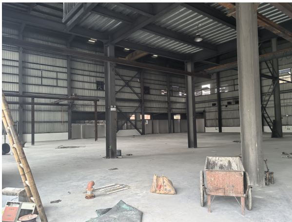
配套表面处理车间现场照片
